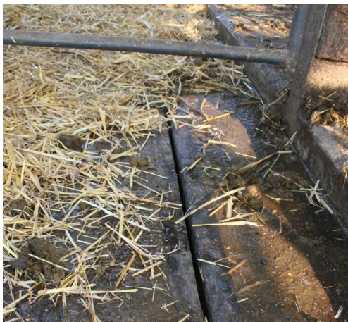
Abb. 3: Die Schlitzrinne sorgt für sichere Entwässerung und weitgehend trockene Laufflächen.
