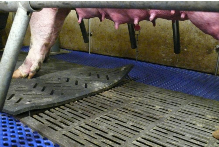
Abbildung 6: Eine falsch montierte Gummimatte wird von der Sau „herausgehobelt“
