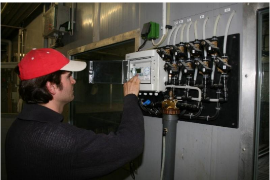
Abb. 7: Meister Joachim Hinterlang stellt die Neopredizid-Anlage ein.
