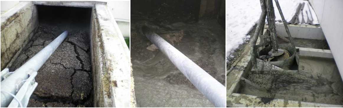
Bilder links: Mobile Rührwerke zum Homogenisieren von Gülle sowie unterschiedlich dicke Schwimmschichten auf der Gülle
