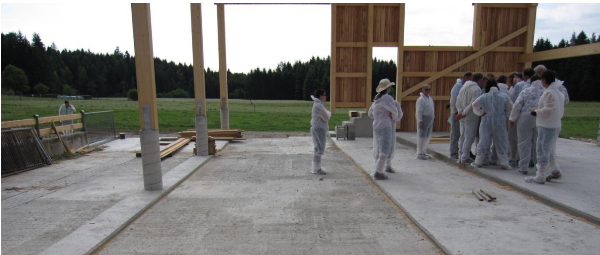
Abb. 1: Der sich im Bau befindliche Maststall der Familie Stark in Litschau wurde ausgiebig diskutiert
