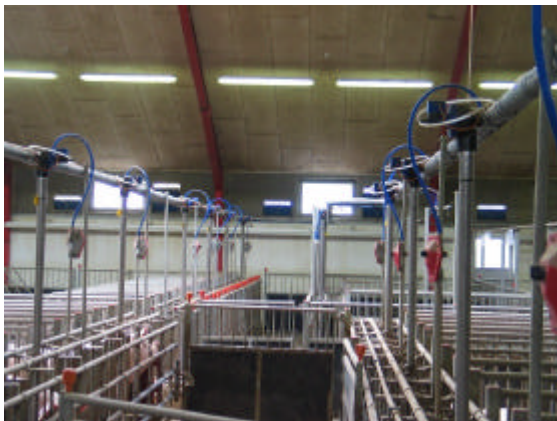
Bild 1: Zuluftführung über Wandventile, Decke mit Heraklit-Platten gedämmt
