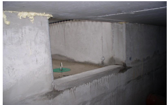
Zuluftführung in das Abteil
