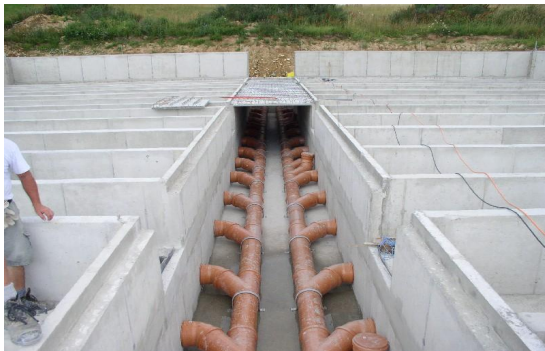
Zuluftführung unterhalb des Zentralgangs
